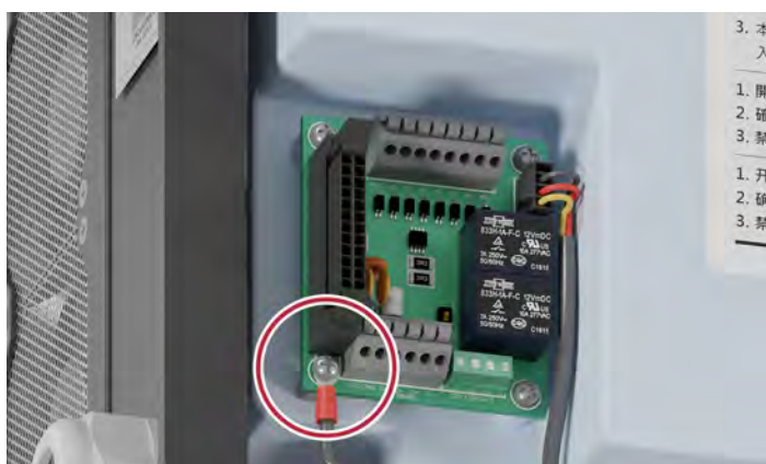
Erdung des RS485-Kabels
