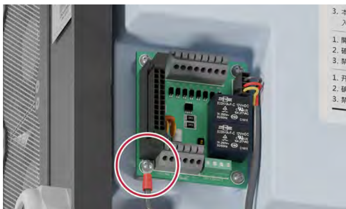
Mise à la terre du câble RS485
