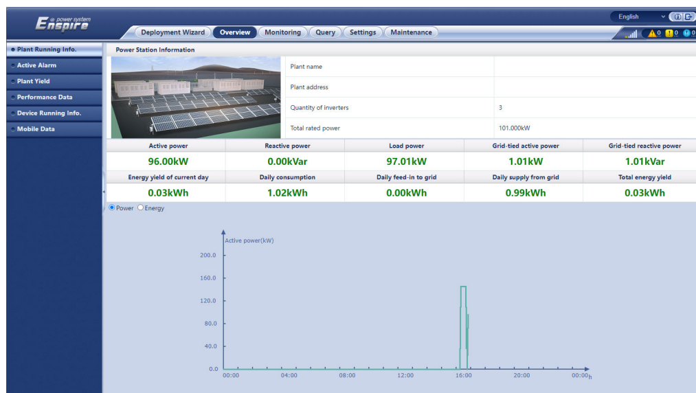
Figure 6-3 Informations relatives à l'exécution de la centrale (avec compteur électrique mais sans batterie)
