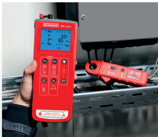
DC-Betriebsstrommessung mit BENNING CC 3
